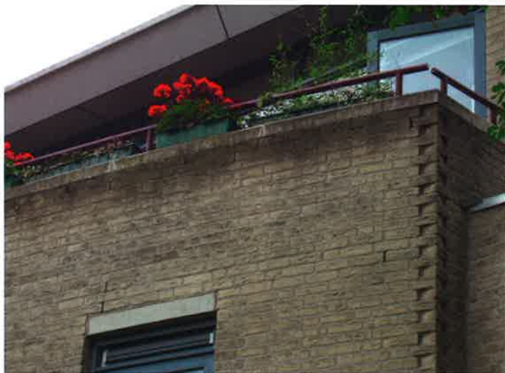
Vervuiling door ontbreken overstek muurafdekker
